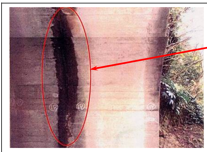
箇所：損傷部②
